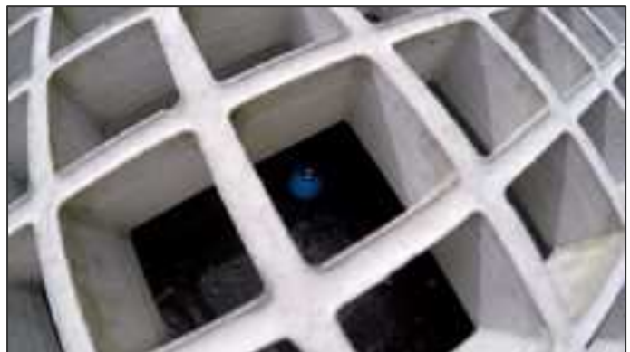
Flotteur vu au travers du caillebotis
